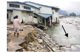
上流部被災状況（高山市清見町藤瀬）
