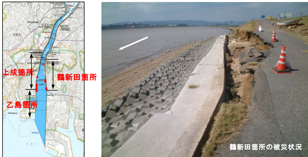
図 4-1-3 H16.8 高潮による被災箇所
