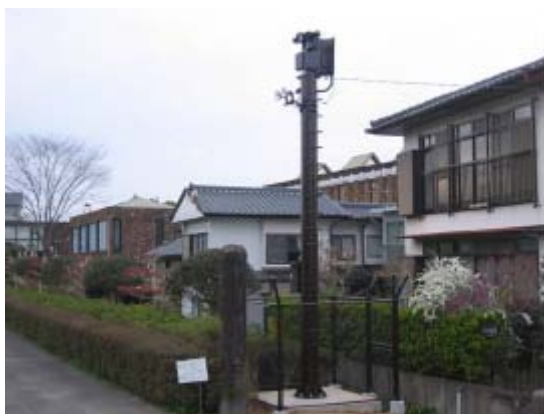
【人吉市街部の CCTV 施設】
