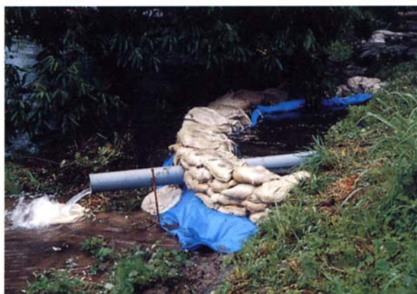
図-9.9 益田市安富地区の堤防漏水状況
