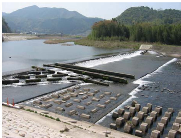
図-5.1 高津川水系最大の取水施設「剣先頭首工」(匹見川)
