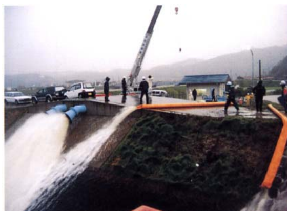
図-9.10 益田市神田地区救急内水ポンプ稼働状況
