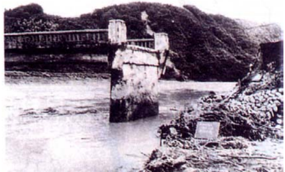
S47.7 洪水(S47.7 豪雨)の 被災状況写真
