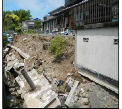
人工斜面崩壊状況（熊本県益城町）
