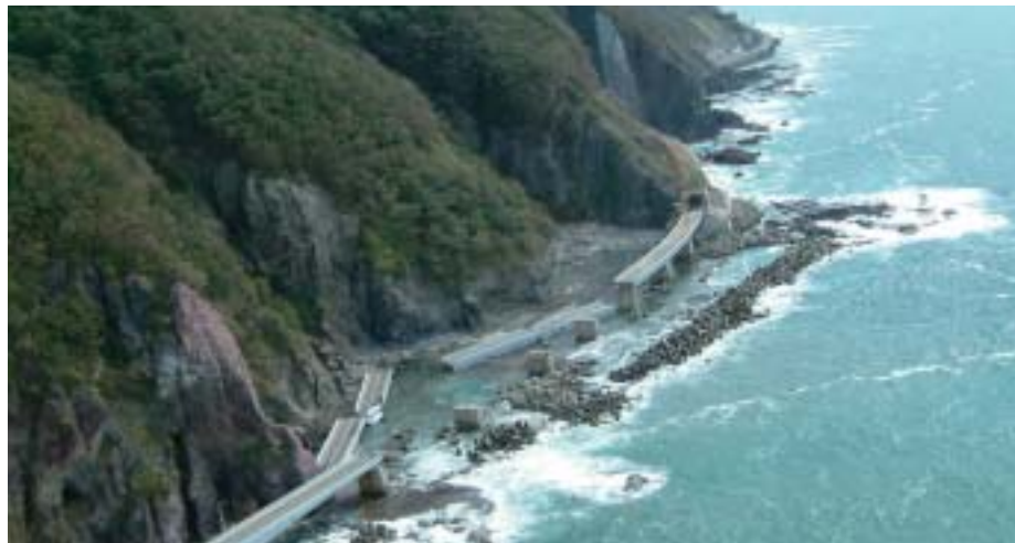
▲高波で橋げたの一部が落下した国道229号の大森大橋（北海道神恵内村）〔写真提供／北海道開発局〕
