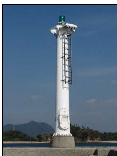
アンカーボルト露出
