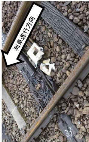
地上子破損 (40k313m付近)
