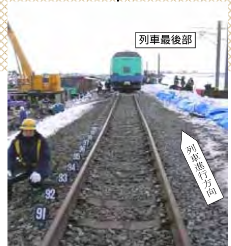
91まくら木付近から新津駅方の損傷
