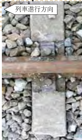
101~103まくら木の損傷
