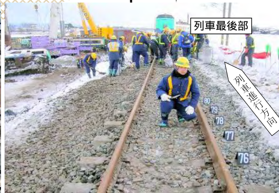
76まから木付近から新津駅方の損傷
