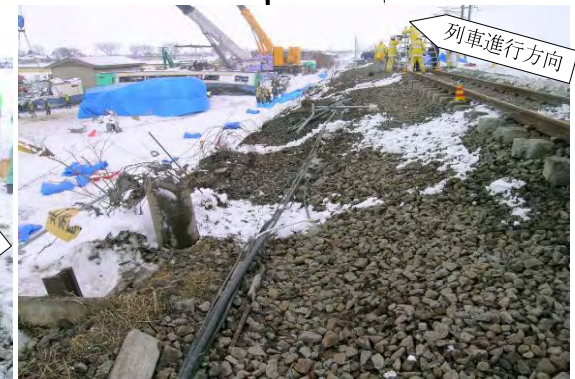
62まから木付近の電柱損傷及び道床崩壊等
