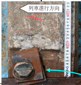
10bまくら木の損傷
