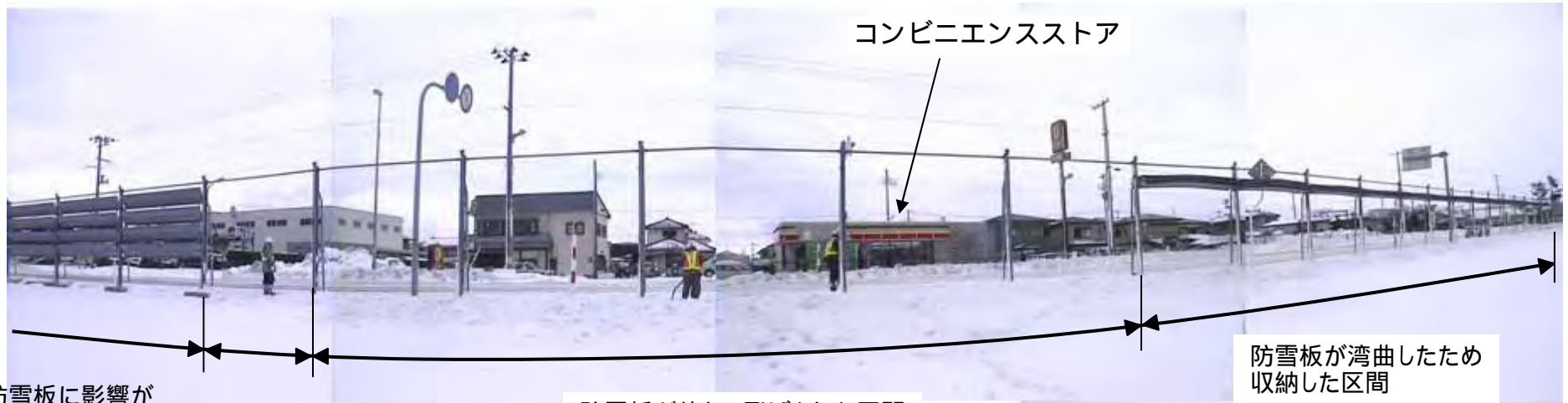
付図3 2 広野地区における国道7号線防雪柵の破損(その2)(道路西側から)
