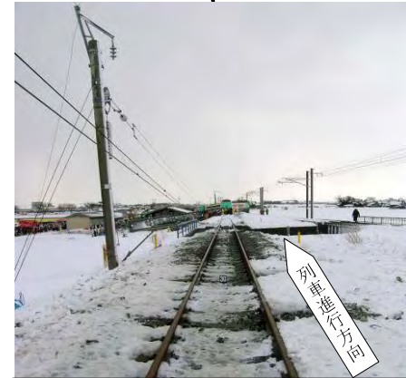
35bまくら木付近から新津駅方の損傷
