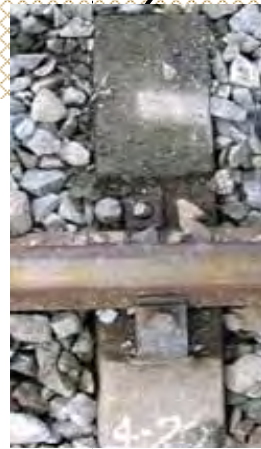
100まくら木の損傷
