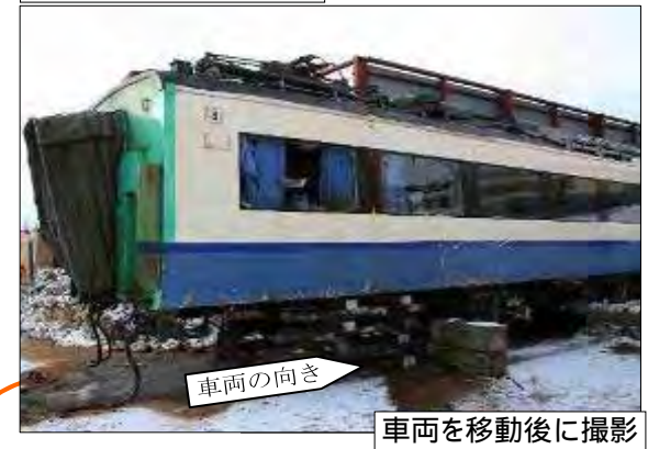
右側面後部の損傷状況
