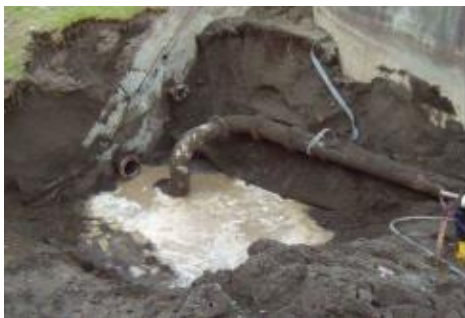
図 3-1-10 処理場内の配管が破断（むかわ町）
