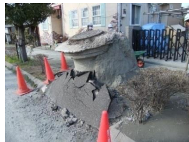
図 3-1-6 液状化により隆起したマンホール（浦安市）
