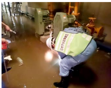
図 3-1-7 エアレーションタンクからの漏水により処理場内が浸水（益城町）
