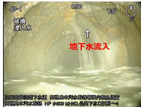
図 3-1-9 地震発生の約 1 か月後に確認された汚水管渠の破損（高槻市）
