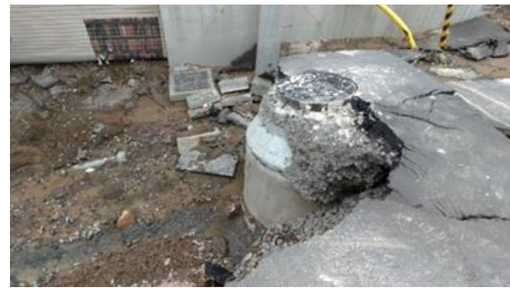
図 3-1-11 液状化による被災（札幌市）
