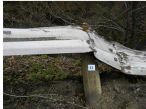
写真 25-6 ガードレール傷跡⑥
