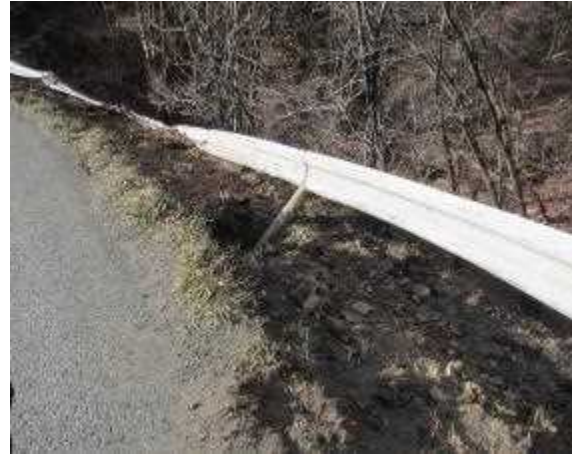
参考写真 20 転落地点その 2
