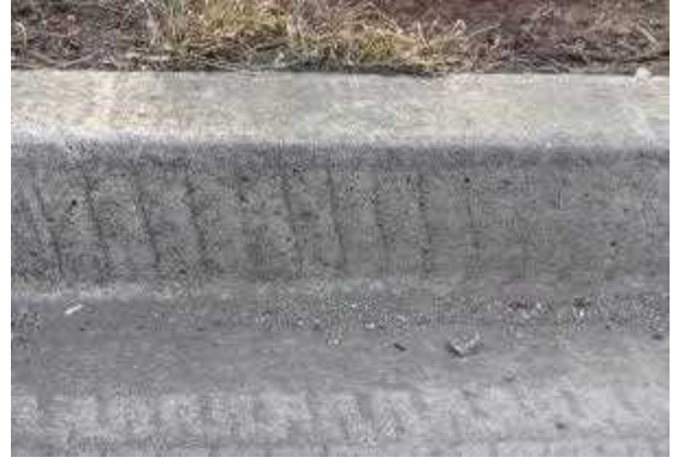
参考写真 16 左側縁石のタイヤ痕 (100m手前)
