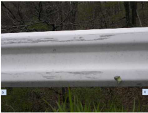
写真 25-1 ガードレール傷跡①
