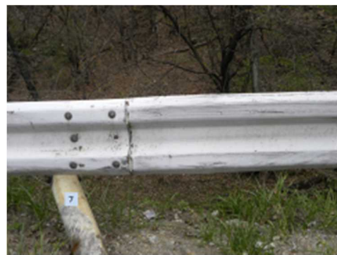
写真 25-2 ガードレール傷跡②
