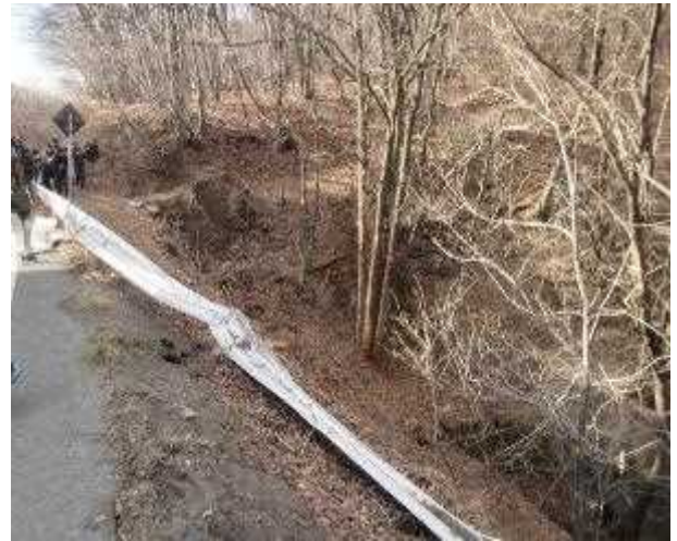
参考写真 22 転落地点その 4
