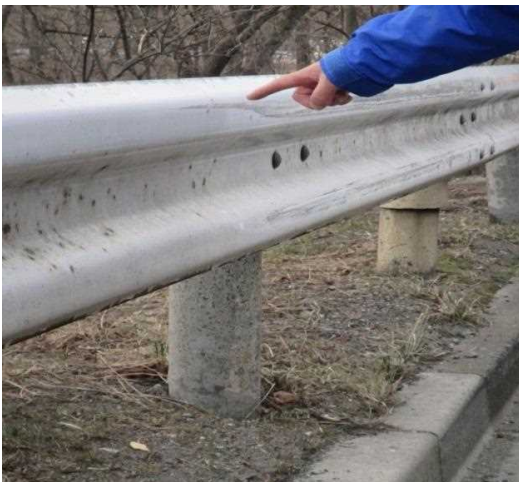
参考写真13 左側ガードレールの 接触痕 (100m手前)
