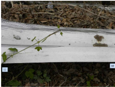
写真 25-5 ガードレール傷跡⑤
