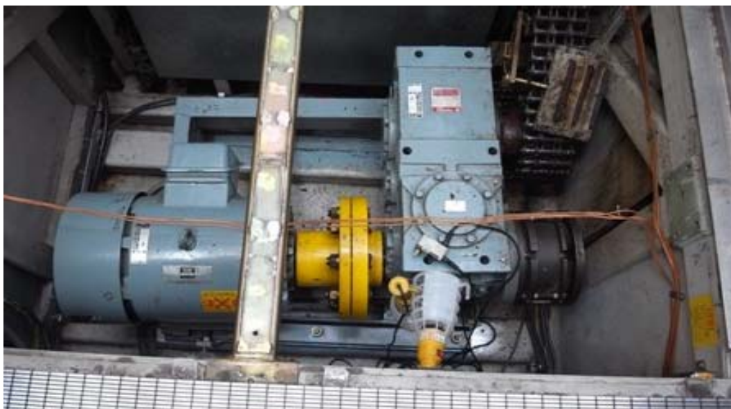
写真16. 事故発生時の駆動装置の状況
