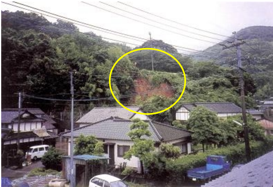
崩壊斜面遠景
