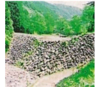
「般若谷」の巨石えん堤 (岐阜県)
