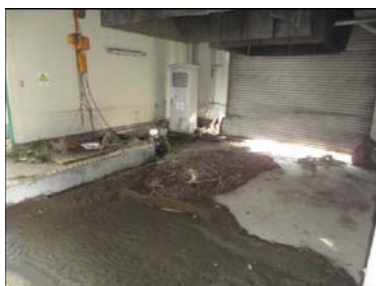
ホッパー室津波により操作盤浸水
