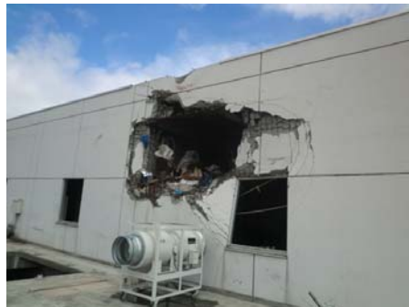
最初沈殿池上屋への漂流物による壁面破断
