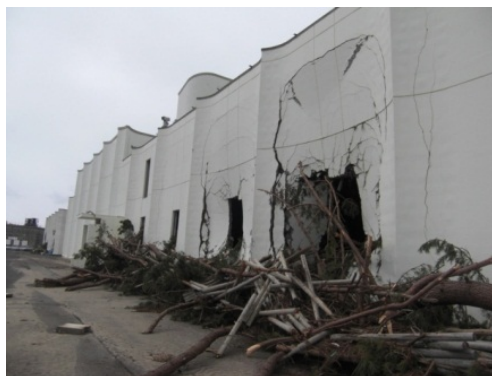
漂流物による建築物への直接被害
