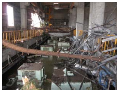
送風機施設への流木等の浸入
