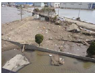
津波による建屋損傷、周囲浸水
