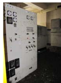
発電機及び発電機盤他水没、全機能停止
