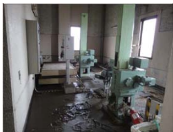
流入ゲート、操作盤浸水
