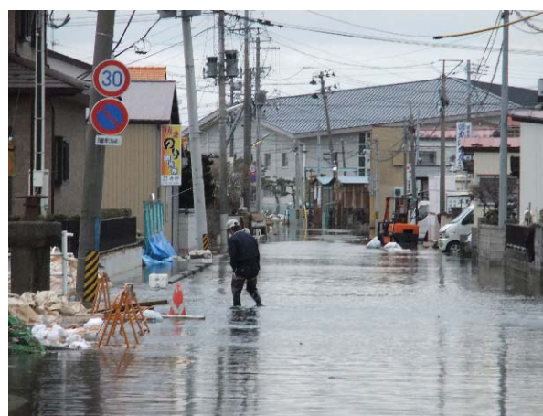
地盤沈下による道路冠水状況（2）
