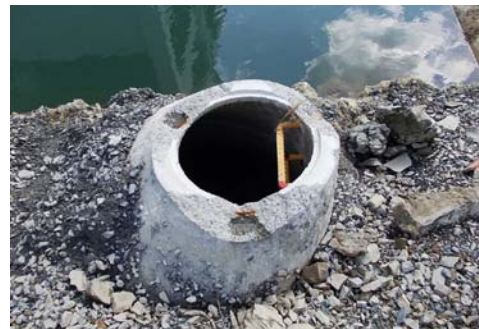
宮城県女川町（蓋の流出）
