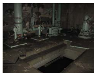
機械・電気設備水没、全機能停止 (汚水ポンプ施設)
