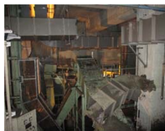
機械・電気設備水没、全機能停止 (沈砂池搬出機)
