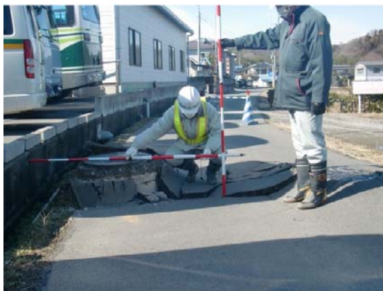
栃木県真岡市人孔突出、路面異常
