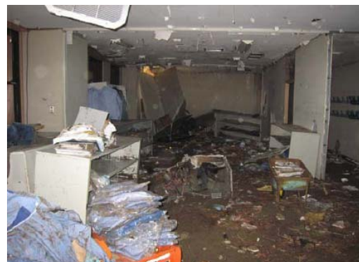
浸水による室内設備の水没被害
