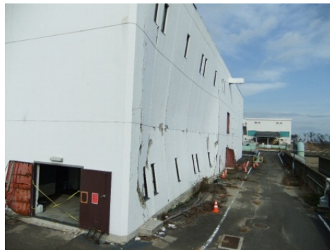
波圧による津波浸入方向の壁面被害
