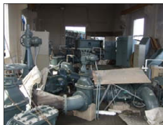
ポンプ場内部
