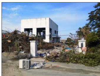
ポンプ場入口フェンス流出
