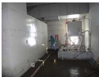
自家発電施設浸水
