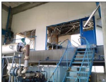
2階操作室 「破損・流出」
