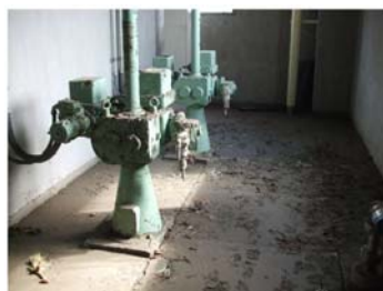
流入ゲート開閉操作者の電気設備 が浸水、全機能停止 (流入渠)
