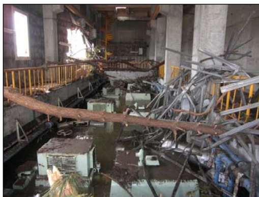
写真 3-4 南蒲生浄化センター (送風機棟への流木浸入)
