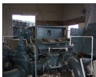
高圧受電盤他転倒
