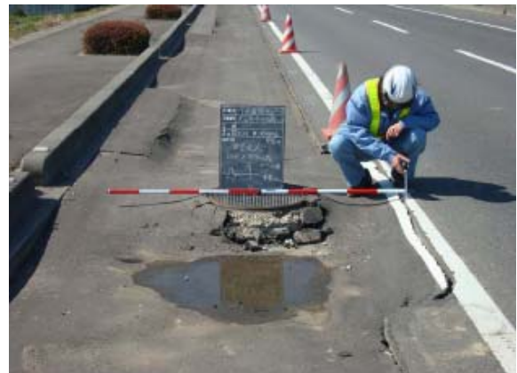
栃木県大田原市人孔突出、路面異常
