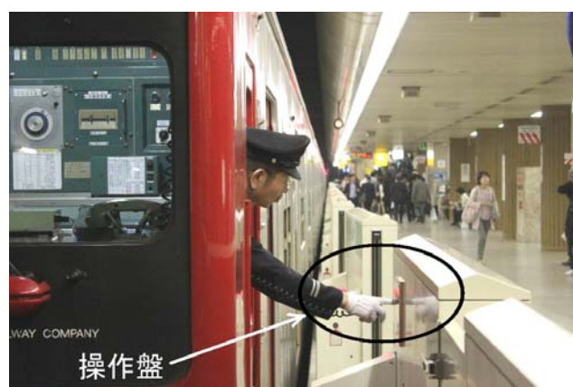
ホームドア操作盤
