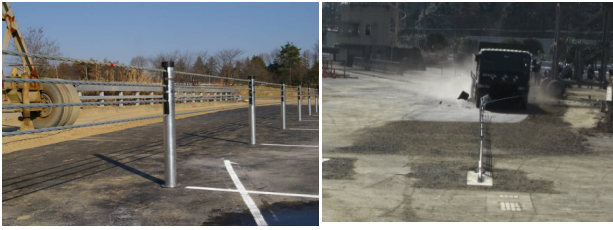
写真-7 改良した防護柵 写真-8 大型貨物車衝突状況
