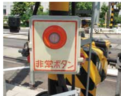
支障報知装置(非常ボタン)
