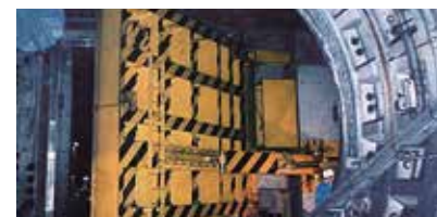
トンネル内の防水ゲート
