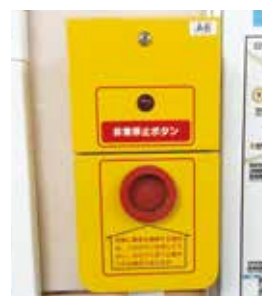
非常停止押しボタン
