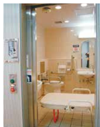
移動制約者用トイレ(個室)
