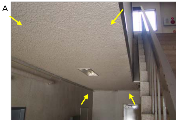
A 階段やホールの天井に吹きつけられたパーミキュライト・パーライト吹きつけ。これらにも石綿含有の時期があり飛散性石綿の分類に入っており、作業者がばく露した可能性があります。
