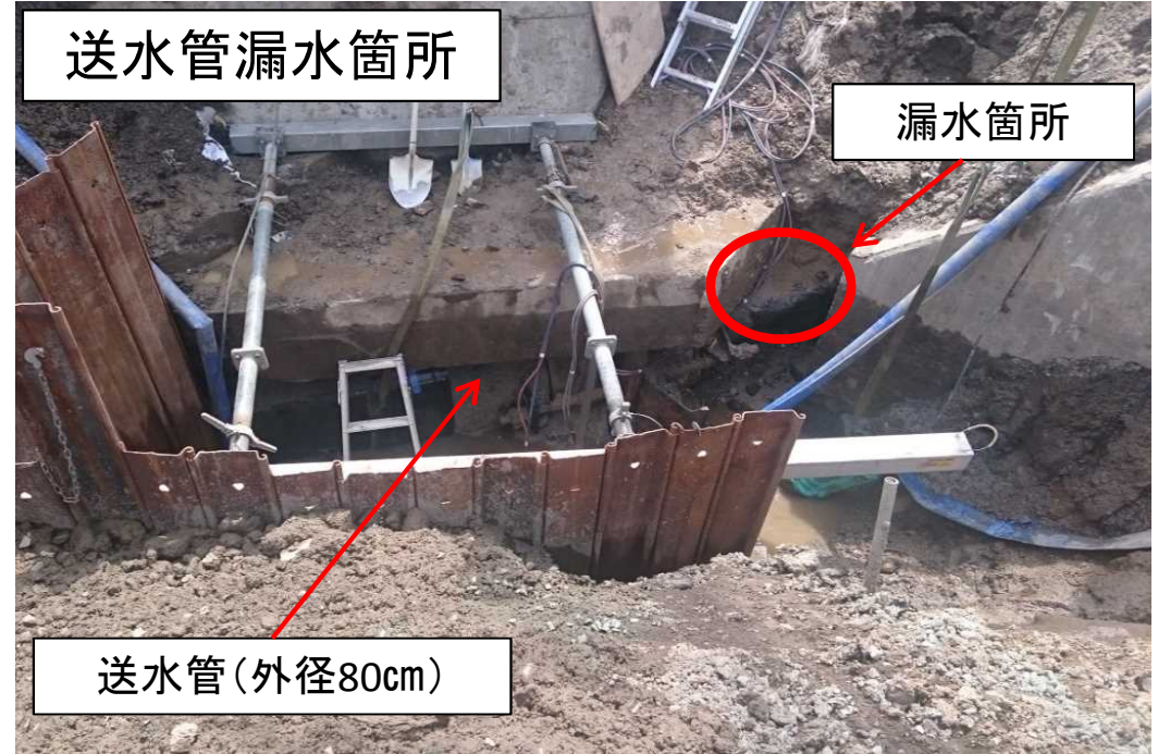
送水管漏水状況
