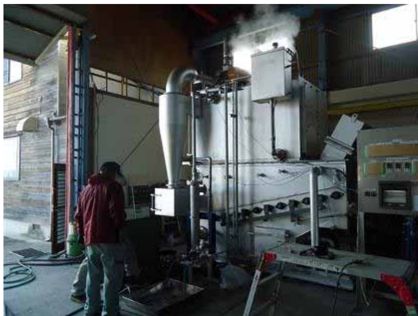
もみ殻ボイラー（試験機）
