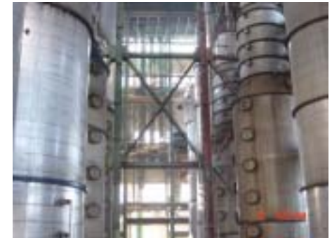
エタノール化プラント
