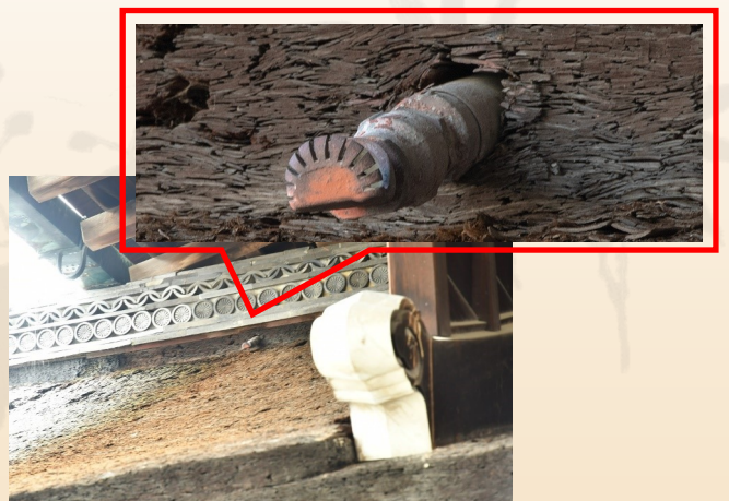
露台屋根 ドレンチャー
