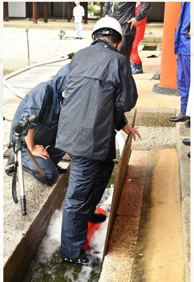
消火設備動作確認 紫宸殿東側消火栓水圧確認
