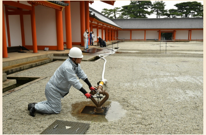
消火設備動作確認 紫宸殿東側消火栓放水
