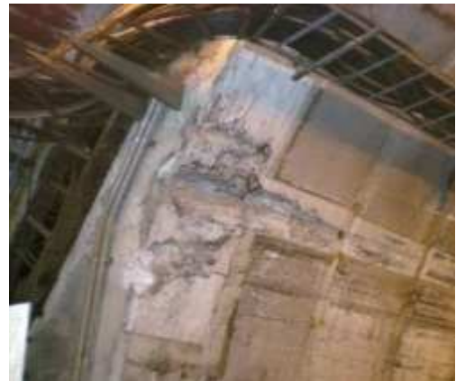
大型車による覆工の擦り状況
