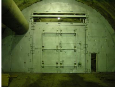
写真 3-2-3 防音扉の状況
