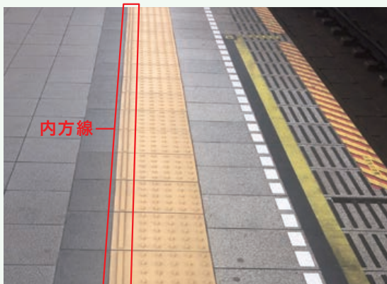
内方線付き点状ブロック
