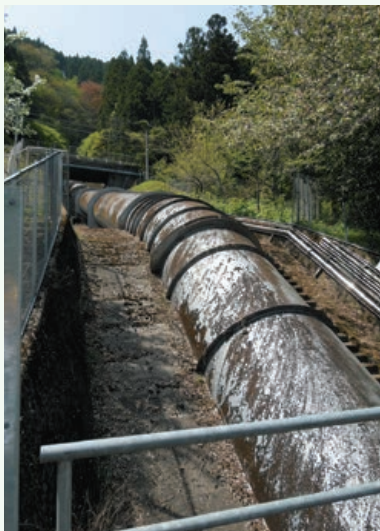
多摩川第三発電所 水圧鉄管
