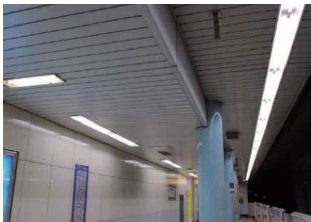
駅施設LED照明
