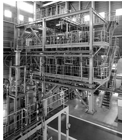
図 3 0.1トン/日 石炭液化連続反応装置 (BSU: Bench Scale Unit, 高砂製作所内)
