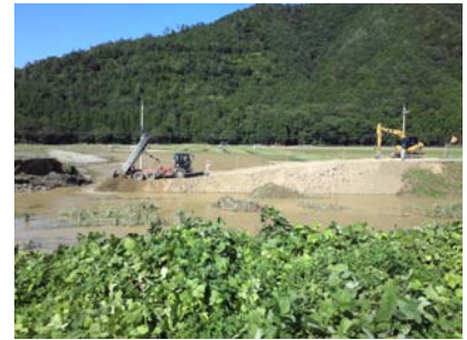
写真-2 応急復旧状況（野木川）
