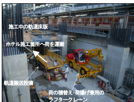
写真-5 軌道搬送設備
