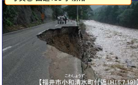
写真② 国道158号 崩落
