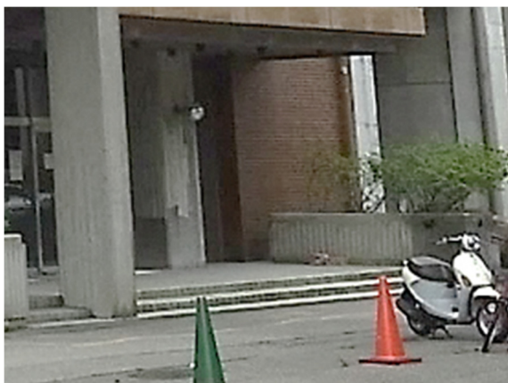
入口にスロープがない（大学院棟出入口（1F））
