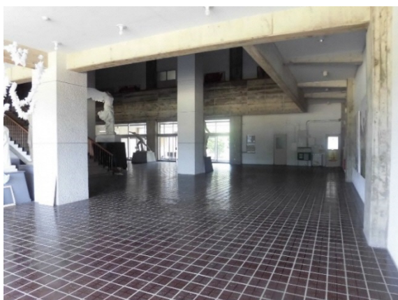
ベンチがない（1階エントランスホール）
