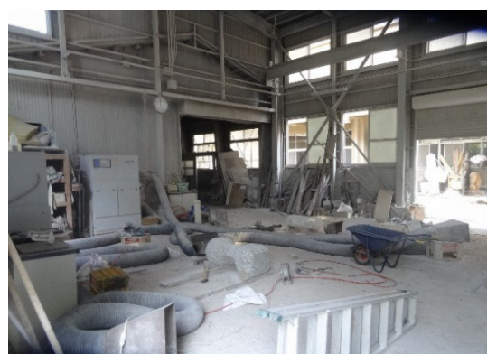
防音対策がされていない石彫棟
