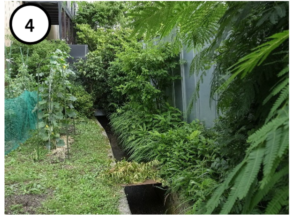
隣接する住宅との離隔が狭い
