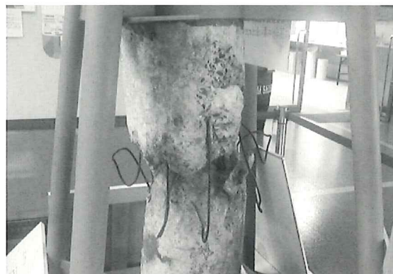
■東水環境センターに収蔵・展示されている被災下水道構造物
