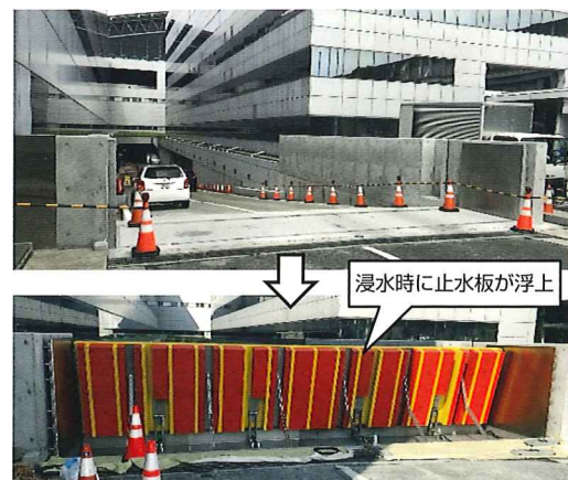
■浸水対策：ターミナルビル地下入口に浮上式止水板を設置
