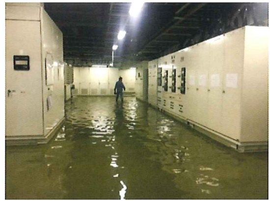
■ターミナルビル地下電気室の浸水
