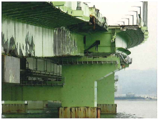
■タンカーの衝突による連絡橋桁の損傷
