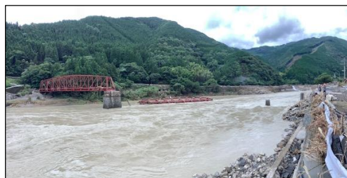
[橋りょう流失]
