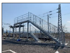
[車両屋上機器点検台]
