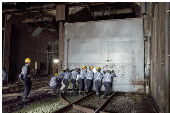
[トンネル内防水扉の閉扉]
