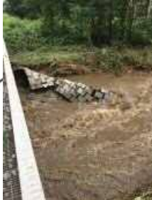
【護岸変状】 根室線 十勝清水～羽帯 155k304m付近 魚捕川橋りょう
