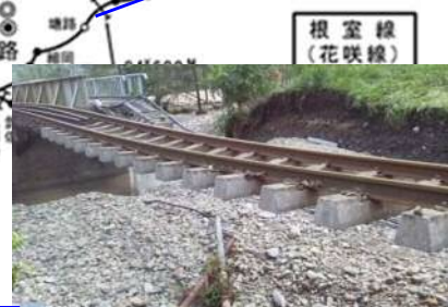
【路盤流出】 根室線 御影～茅室 茅室川橋りょう
