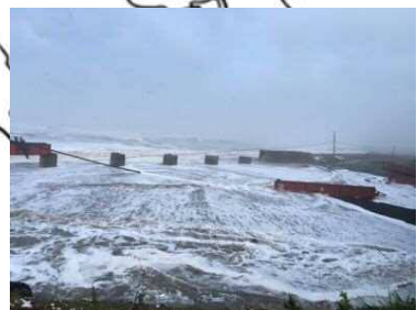
【橋りょう流失・路盤流出・通信ケーブル損傷】 日高線 豊郷～清島 慶能舞川橋りょう
