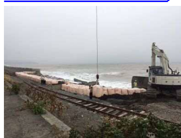
【護岸倒壊】 日高線 新冠～静内 80k328m付近
