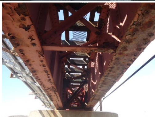
日高線厚別（あっぱつ）川橋りょう （経年による劣化と橋脚の洗掘が進んでいる）
