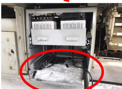
(蓋落失後の制御用バッテリー箱)
