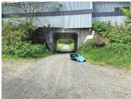
【落下した屋根（一部）】
