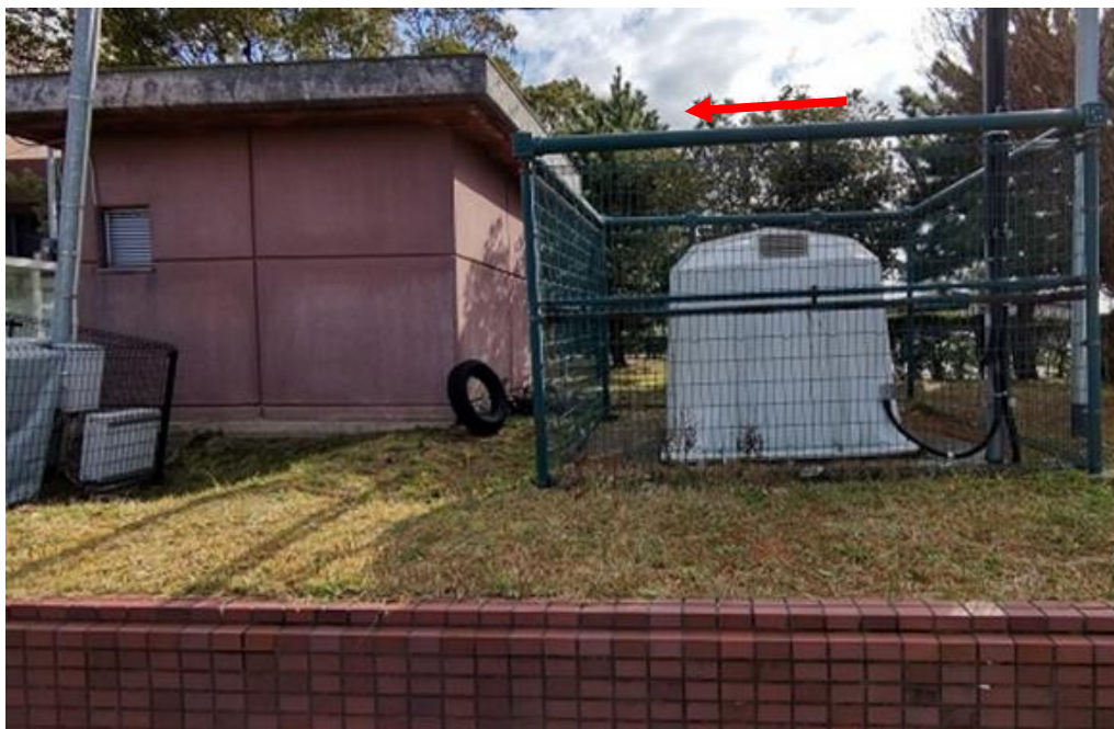
周辺地盤の変形
