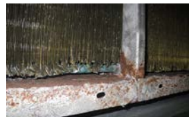
塩害で腐食したラジエーター
