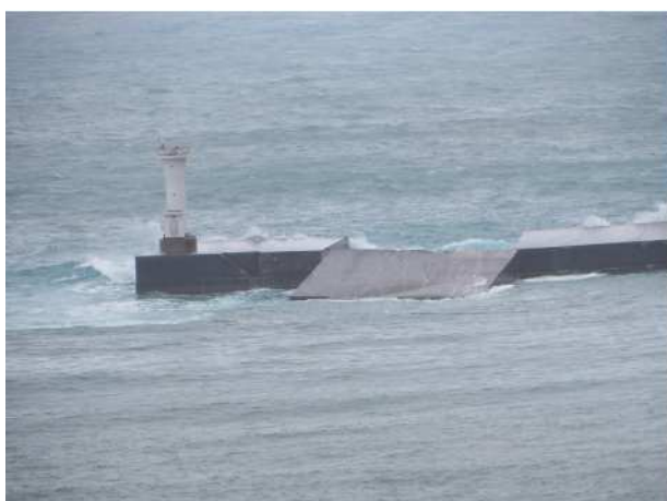
沖縄県渡嘉敷村渡嘉敷港の防波堤損壊 (渡嘉敷村役場提供)
