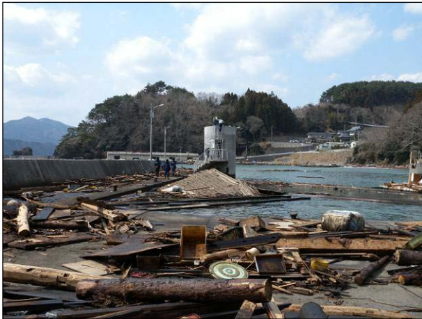
写真 25 防波堤内側の被害状況
