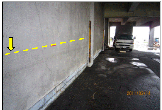
写真 4 津波の痕跡（図 7 の 4）
