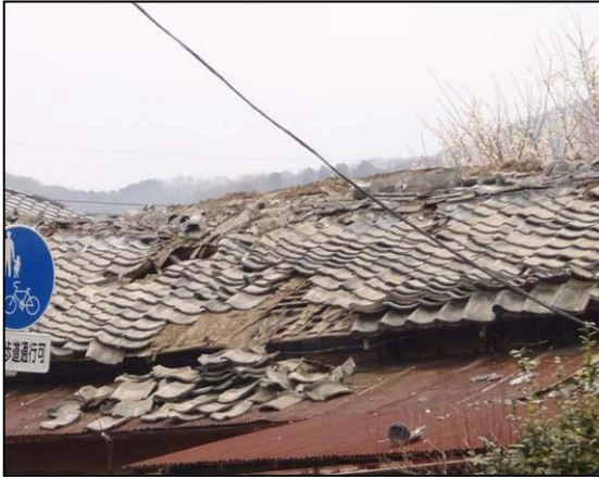
写真 30 群馬県桐生市元宿町 住家の屋根瓦損壊
