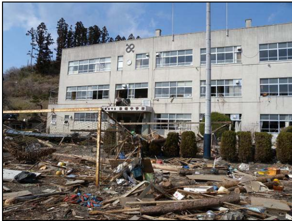
写真 28 校舎の被害状況
