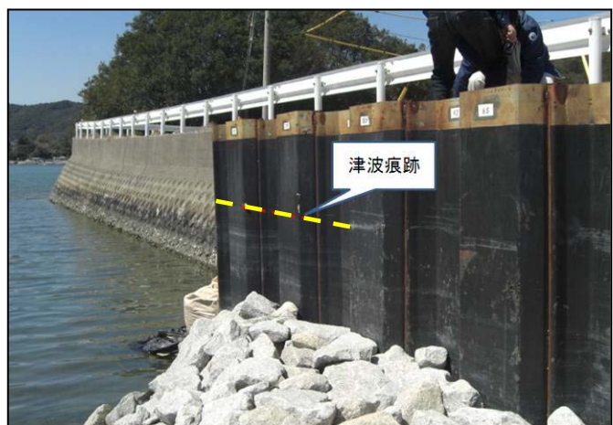
写真 3 津波の痕跡（図 5 の 63）
