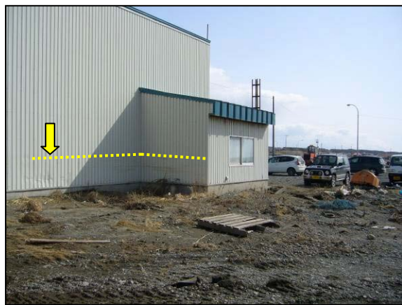
写真 13 津波の痕跡（図 19 の 13）
