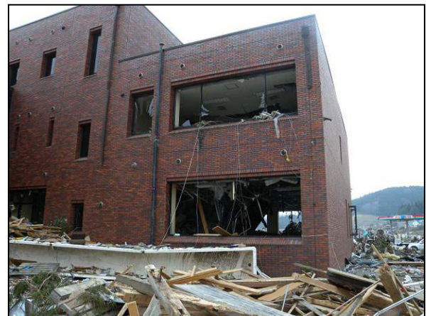
写真 14 2階まで浸水した公民館
