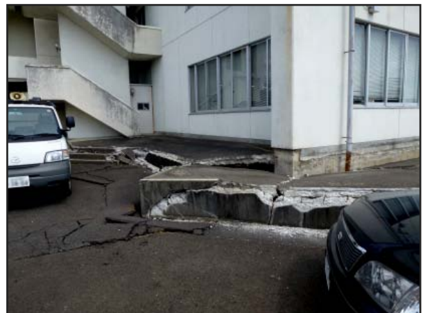
写真 10 栗原市若柳総合支所 庁舎周辺の犬走りの損壊
