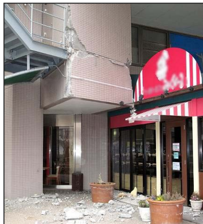
写真 4 仙台市宮城野区 JR 仙石線榴ヶ岡駅付近のビルの損傷
