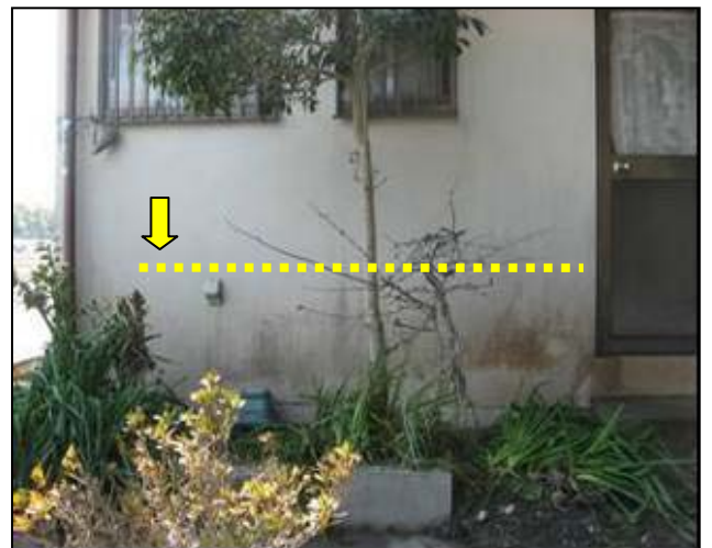
写真 11 津波の痕跡（図 15 の 71）
