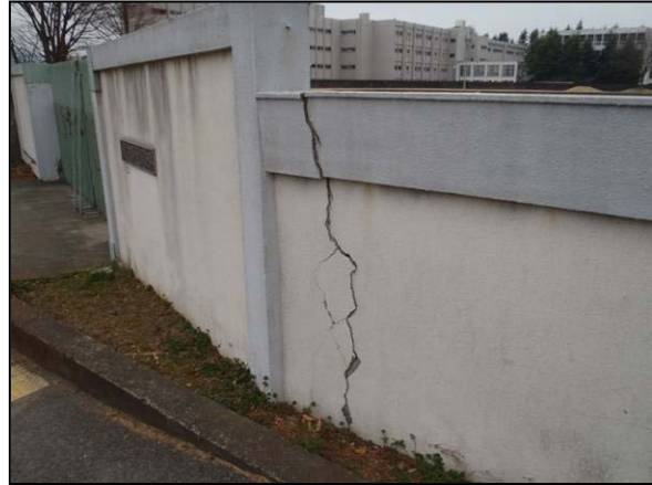
写真 31 群馬県桐生市元宿町 桐生市陸上競技場囲障の亀裂
