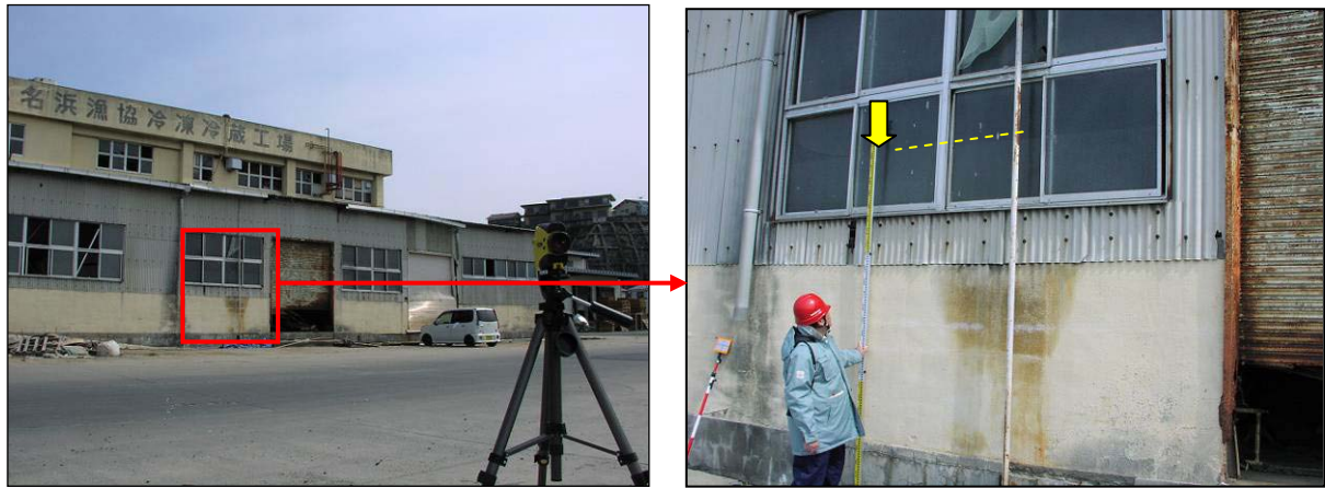
写真 47 津波の痕跡（図 29 の 45）
