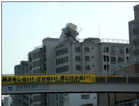
写真 3 仙台市宮城野区 ビル上部の傾いた構造物
