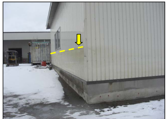
写真 8 津波の痕跡（図 12 の 8）
