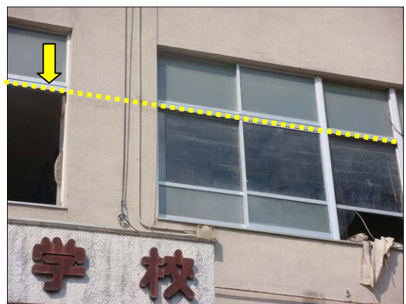
写真 27 津波の痕跡（図 14 の 34）
