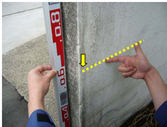
写真 14 津波の痕跡（図 20 の 14）
