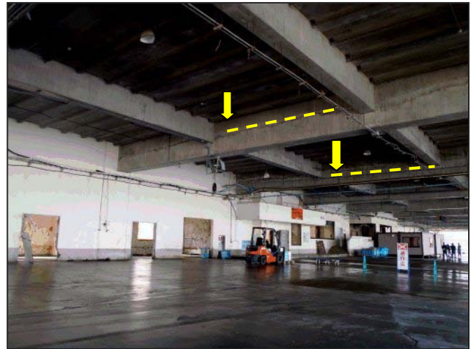
写真 2 津波の痕跡（魚市場内側の柱に痕跡、図 5 の 22）
