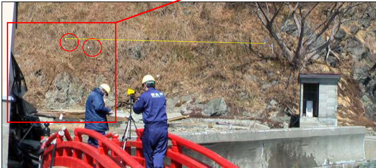
写真 5 津波の痕跡（宮古検潮所付近の傾斜地に漂着物が確認された、図 6 の 24）
