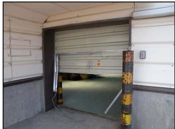
写真 9 倉庫のシャッターが損壊
