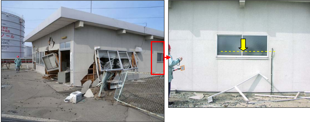
写真 45 津波の痕跡（図 28 の 44）
