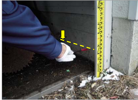
写真 19 津波の痕跡（図 26 の 19）
