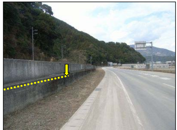
写真 14 津波の痕跡（図 19 の 74）
