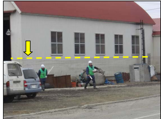
写真 7 津波の痕跡（図 11 の 7）
