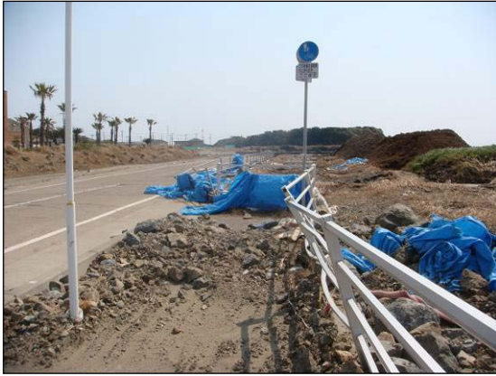
写真 15 千葉科学大学本部正門前の道路ガードレールや標識等が損傷を受け傾いている
