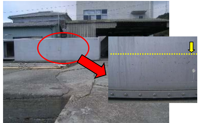
写真 10 津波の痕跡（図 14 の 70）
