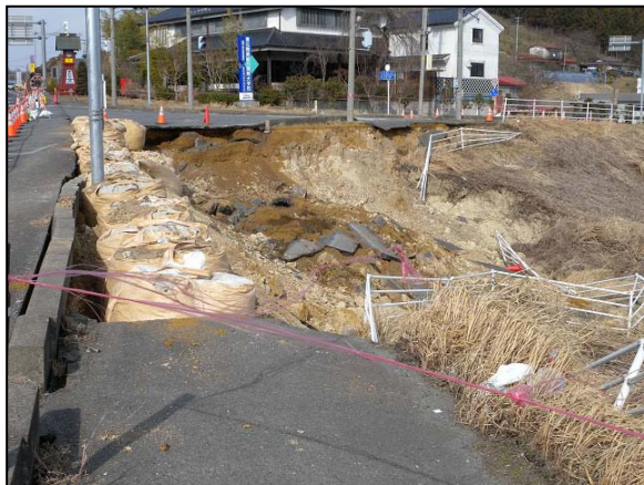
写真 11 栗原市築館国道 4 号線沿いの崖崩れ
