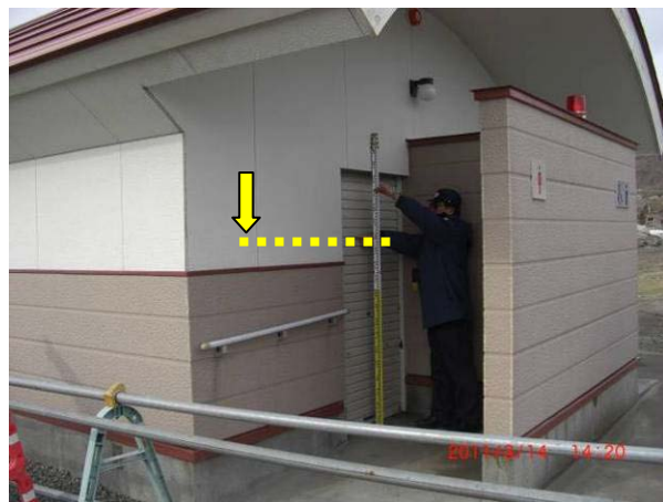
写真 17 津波の痕跡（図 23 の 17）
