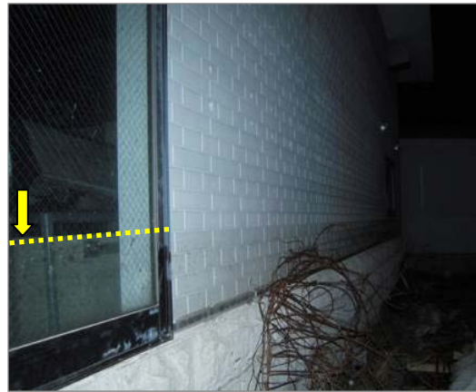
写真 18 津波の痕跡（図 25 の 18）
