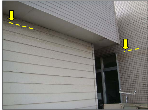
写真 6 津波の痕跡（図 13 の 55）
