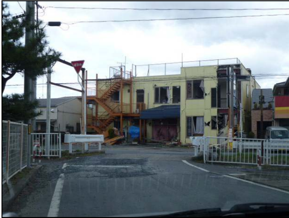
写真 7 中津山第二小学校付近 石巻市桃生町の震度計から北西約 50m の 建物窓ガラスや壁が損壊
