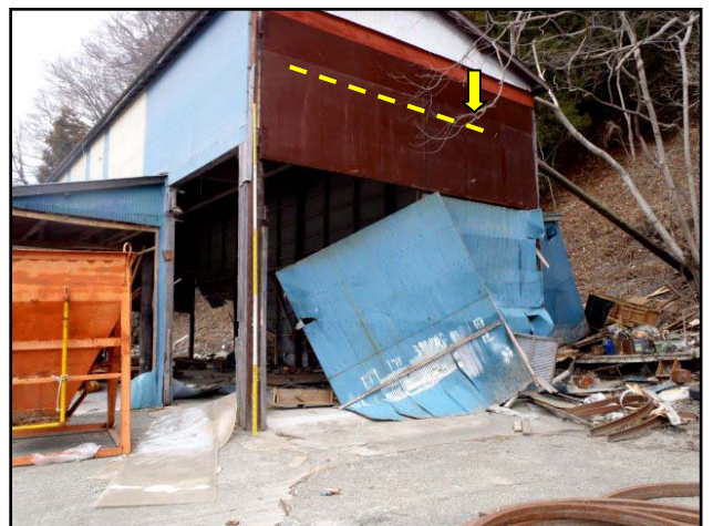
写真8 津波の痕跡（図7の28）
