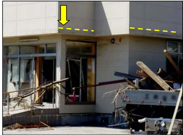
写真 34 津波の痕跡（図 19 の 37）
