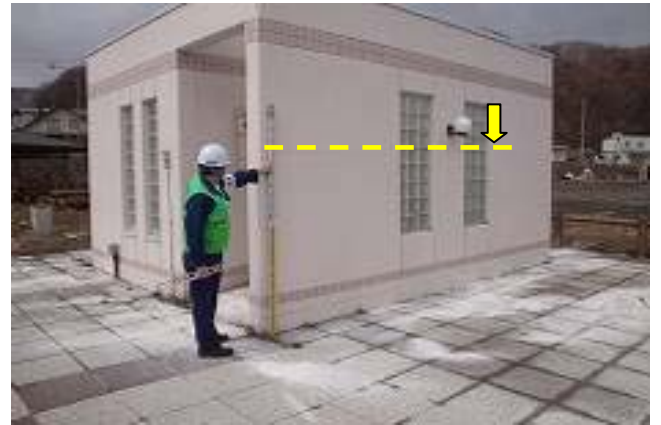
写真 9 津波の痕跡（図 14 の 9）
