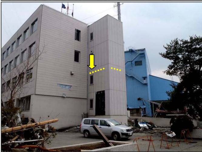
写真9 津波の痕跡（図7の27）
