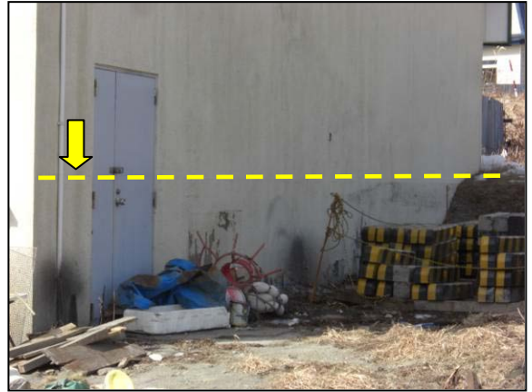
写真 6 津波の痕跡（図 10 の 6）
