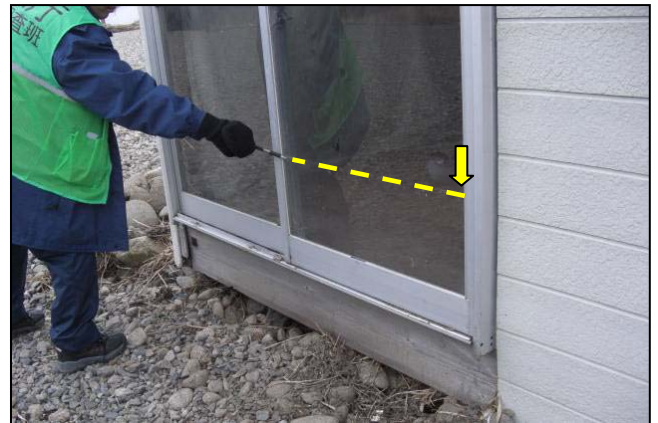
写真 10 津波の痕跡（図 15 の 10）
