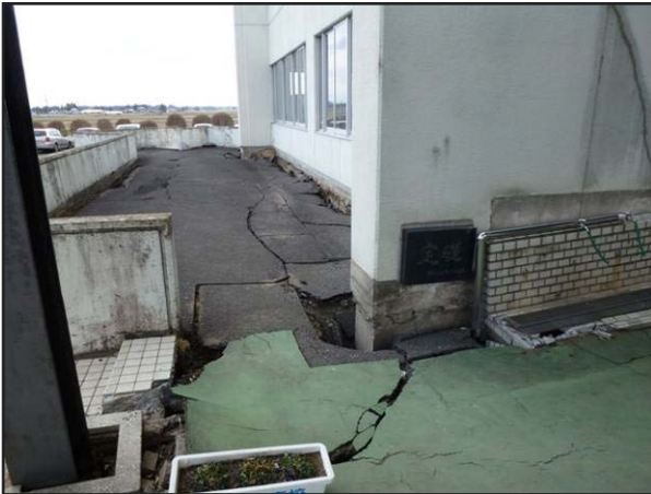
写真 9 栗原市若柳総合支所 玄関北側のアスファルトの破損
