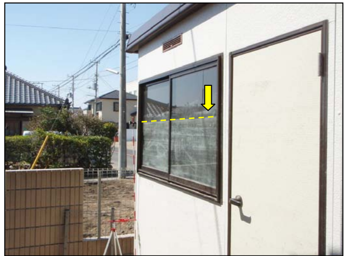
写真 17 津波の痕跡（図 18 の 59）
