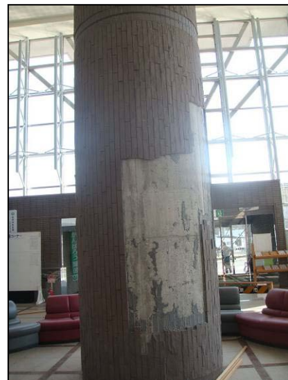
写真 12 栗原市役所の柱タイルの剥離
