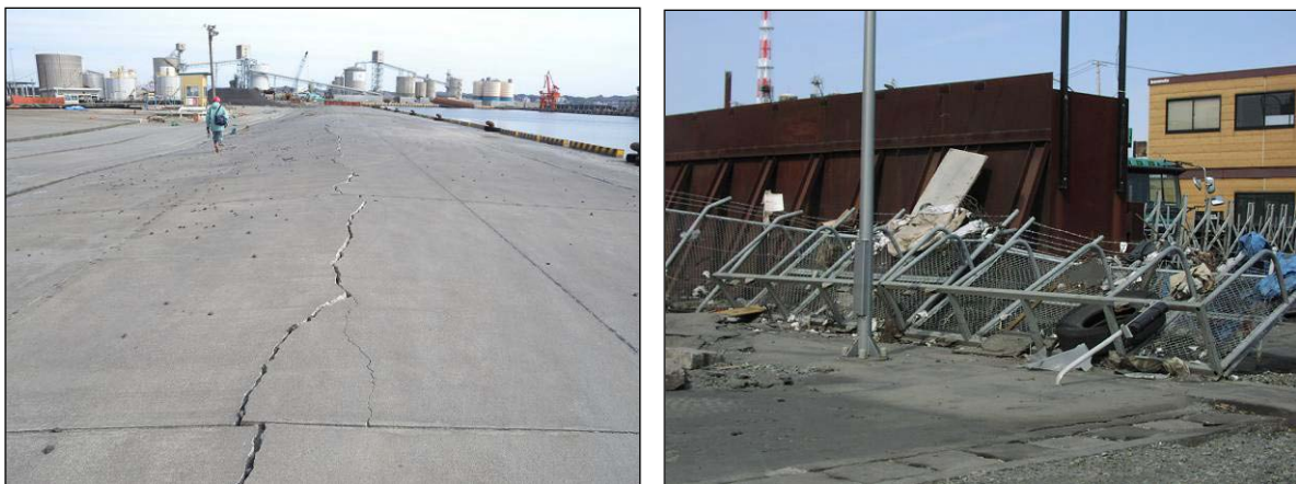
写真 46 小名浜検潮所の周囲の状況 岸壁の亀裂や隆起などの被害が広い範囲で見られたほか、 フェンス類も多数損壊していた。
