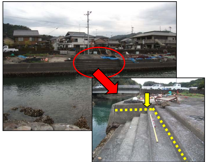
写真 13 津波の痕跡（図 17 の 73）
