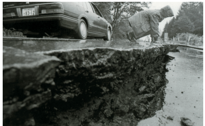
平成6年(1994年)北海道東方沖地震の被害。(毎日新聞社提供) 道路に亀裂が入り15cmもの段差ができた。
