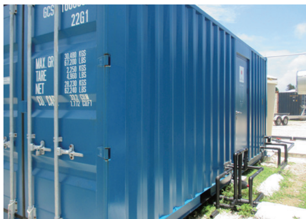
マーシャル:飲料水をつくる海水淡水化装置
