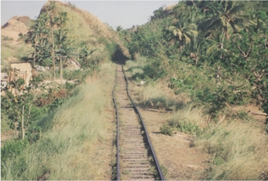
事業実施前(1993年当時)の軌道： 枕木が老朽化し、レールが湾曲
