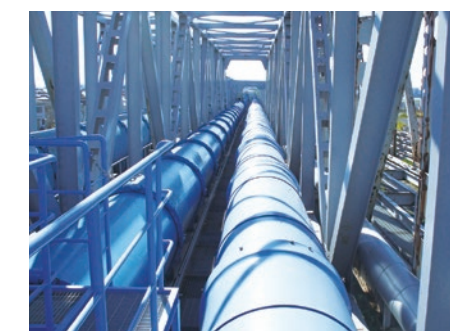
東北電力株式会社新潟火力発電所 発電施設冷却管
