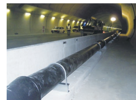
中日本高速道路株式会社 消防用配管
