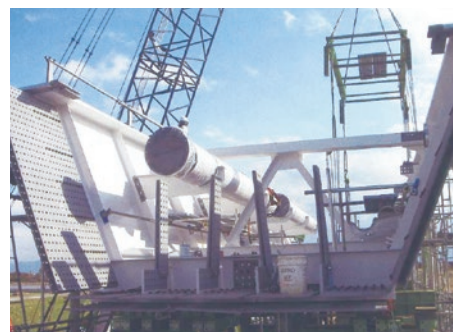
新潟市水道局 橋梁添架配管
