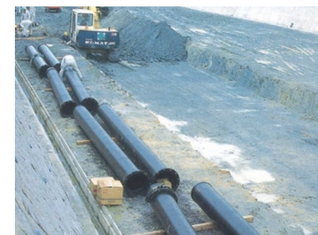
名張近鉄ガス株式会社 ガス導管
