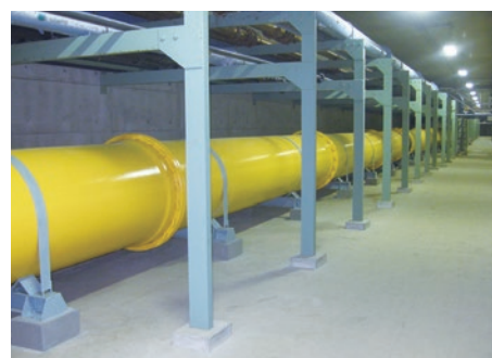
姫路市下水道局 圧送管共同構内配管
