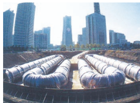
横浜市水道局 耐震貯水槽
