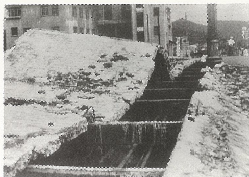
原爆により被災した床版
