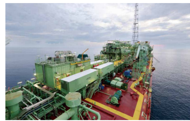
△ 洋上ガス処理設備
