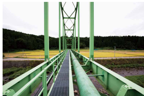
△ 新潟・仙台間ガスパイプライン
