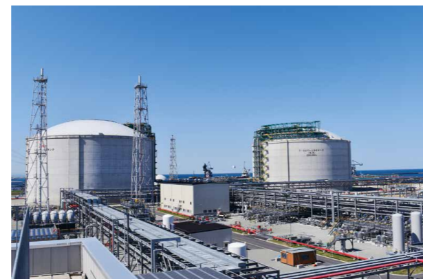
△ 相馬LNG基地
