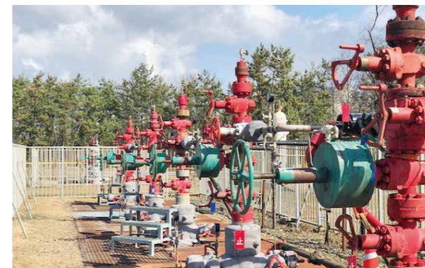
△ CO 2 有効活用の検討を進めている当社国内生産施設
