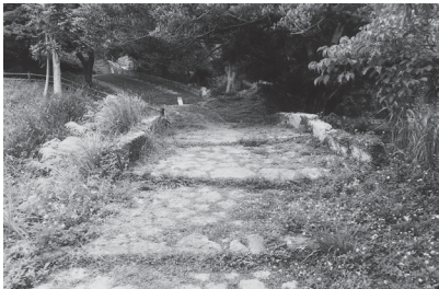
地表から見た現在の比地川橋と取付道路 ※維持管理面に問題あり
