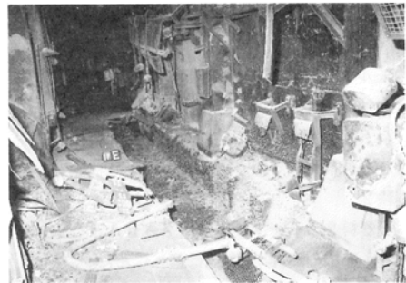
写真2 主変1号3次終端箱付近の状況
