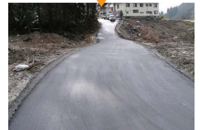
④ 山古志村梶金集落入り口 工事用道路完了 (平成16年12月14日)
