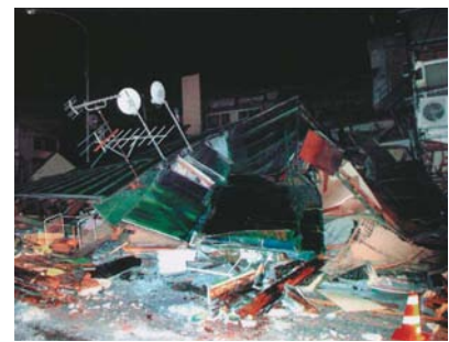
建物倒壊による犠牲者が発生(新潟日報社提供)
