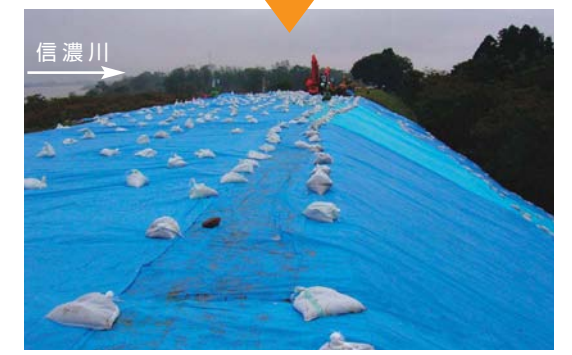
② 長岡市三俣野緊急復旧完了 降雨に備え、崩壊箇所を掘削、盛土、シート張りによる緊急復旧を実施(10月25日24時完了)
