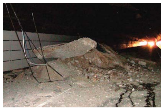
③ 国道17号川口町和南津 トンネル損壊 和南津トンネルで覆工コンクリート剥離等の損傷が発生
