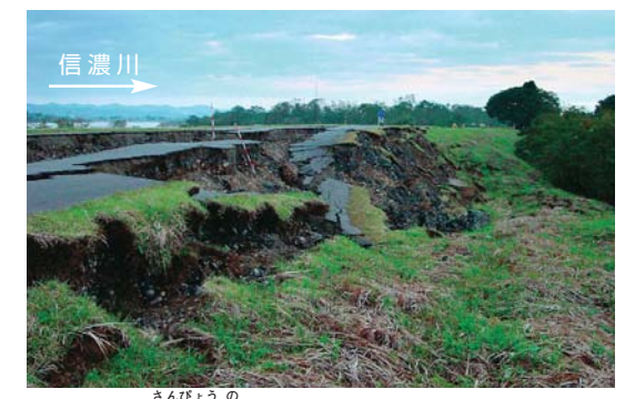
② 長岡市三俣野堤防裏法崩れ 信濃川右岸三俣野地先で150mに渡る裏法崩壊が発生
