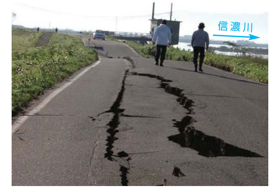
① 中之島町長呂堤防天端亀裂 信濃川右岸長呂地先の堤防天端で450mに渡り、大きな亀裂が発生
