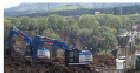
道路陥没のバックホウによる土砂搬出
