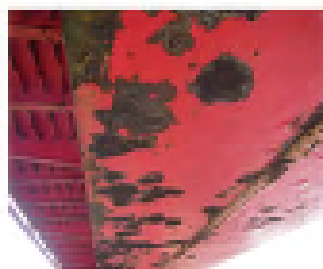
橋梁(鉄橋)の老朽化(新潟県佐渡郡)
