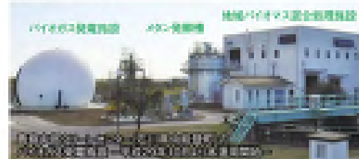
下水汚泥と食品廃棄物などを混合処理し、発酵の過程で発生するメタンガスを燃焼させ発電を行っています。また、処理後の汚泥は製糖の副産物により乾燥させて燃料化し、資源循環を図ります。
