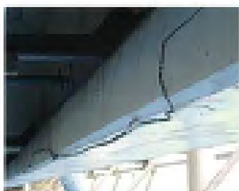
橋梁(コンクリート橋)の破損(新潟県新潟市)
