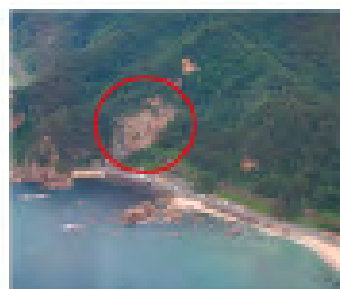
国道345号弘法トンネル付近の落石が発生(新潟県村上市)
